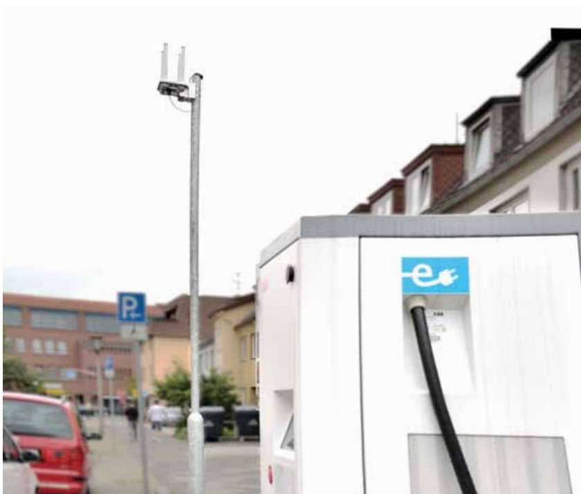
Schnellladesäule im Wolfsburger Stadtgebiet mit WLAN-Router
